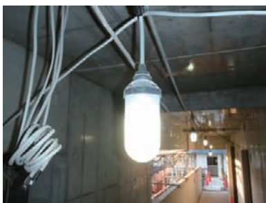
仮設通路照明にLED球を採用
