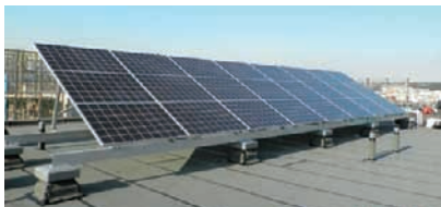
屋上に設置された太陽光発電システム
